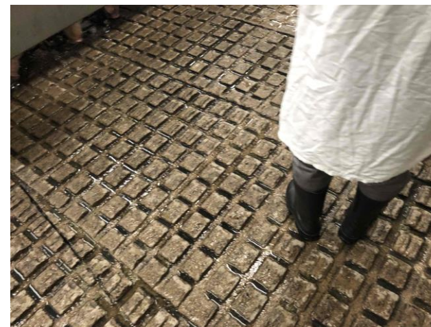
けい留所の床の滑り止め
